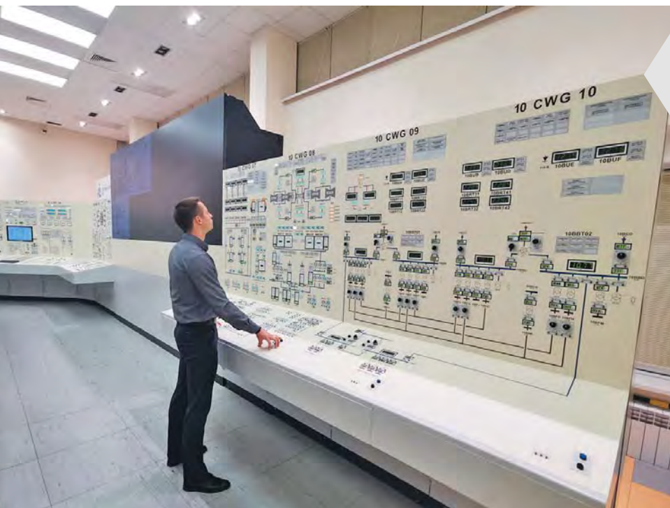
Тренировка на полномасштабном тренажере блочного пульта управления атомной электростанции с ВВЭР-1200, Нововоронежская АЭС, 2019
