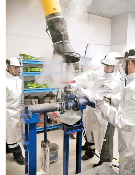
Локализовать течь, не останавливая работу оборудования, может только высококлассный специалист
